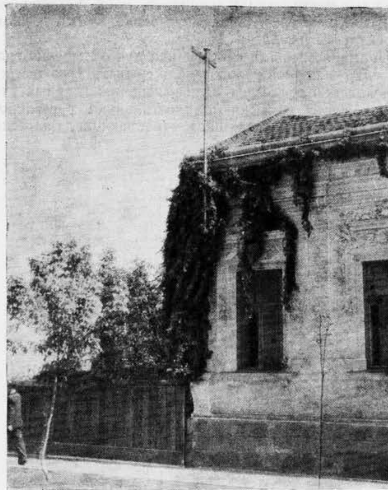
Рис. 2. Бесстолбовая проводка проводов питания фонарей, г. Ужгород.
