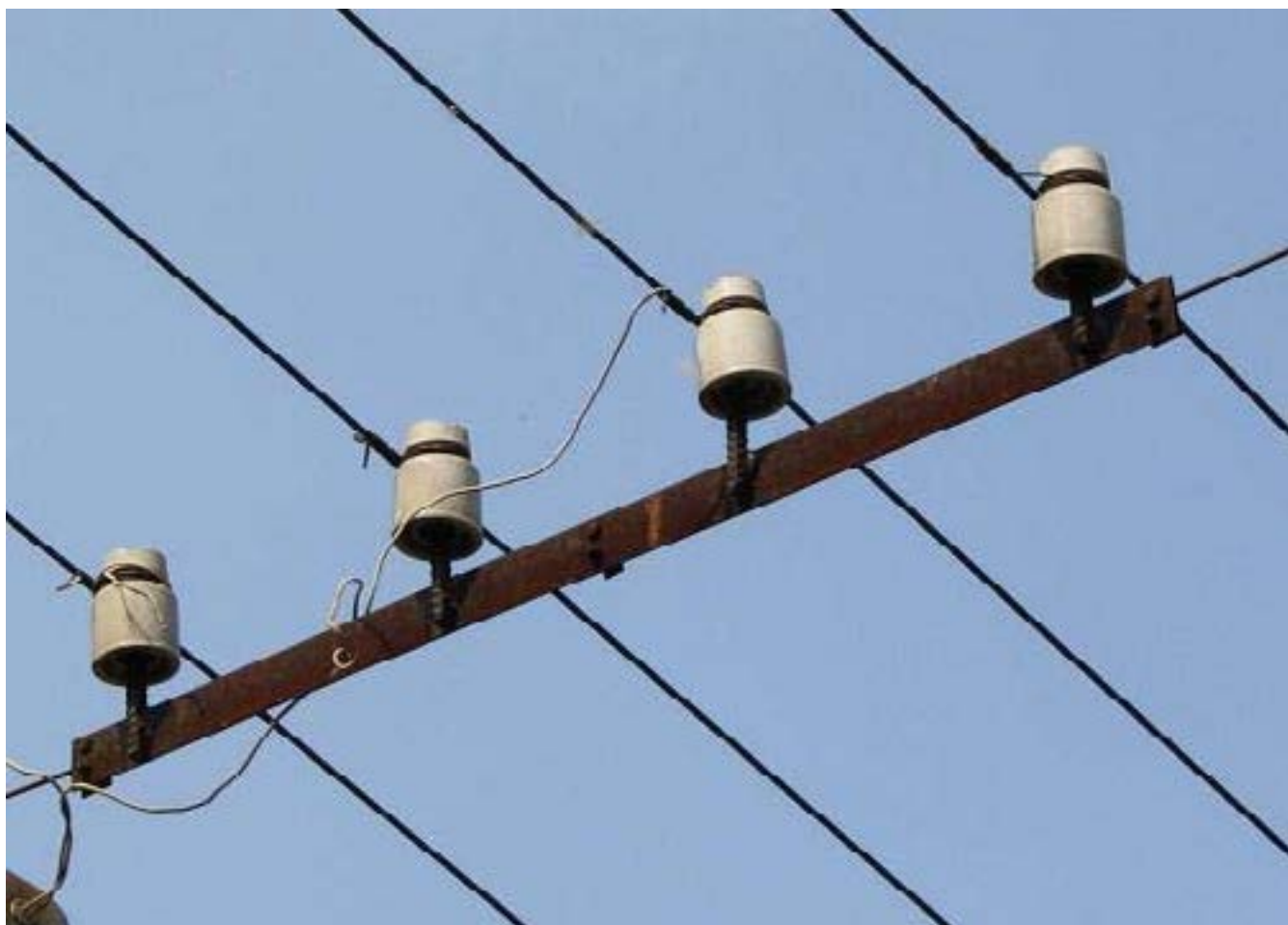
Рис. 118. Обновленная полоса с изоляторами для проводов образца конца 1980-х.
