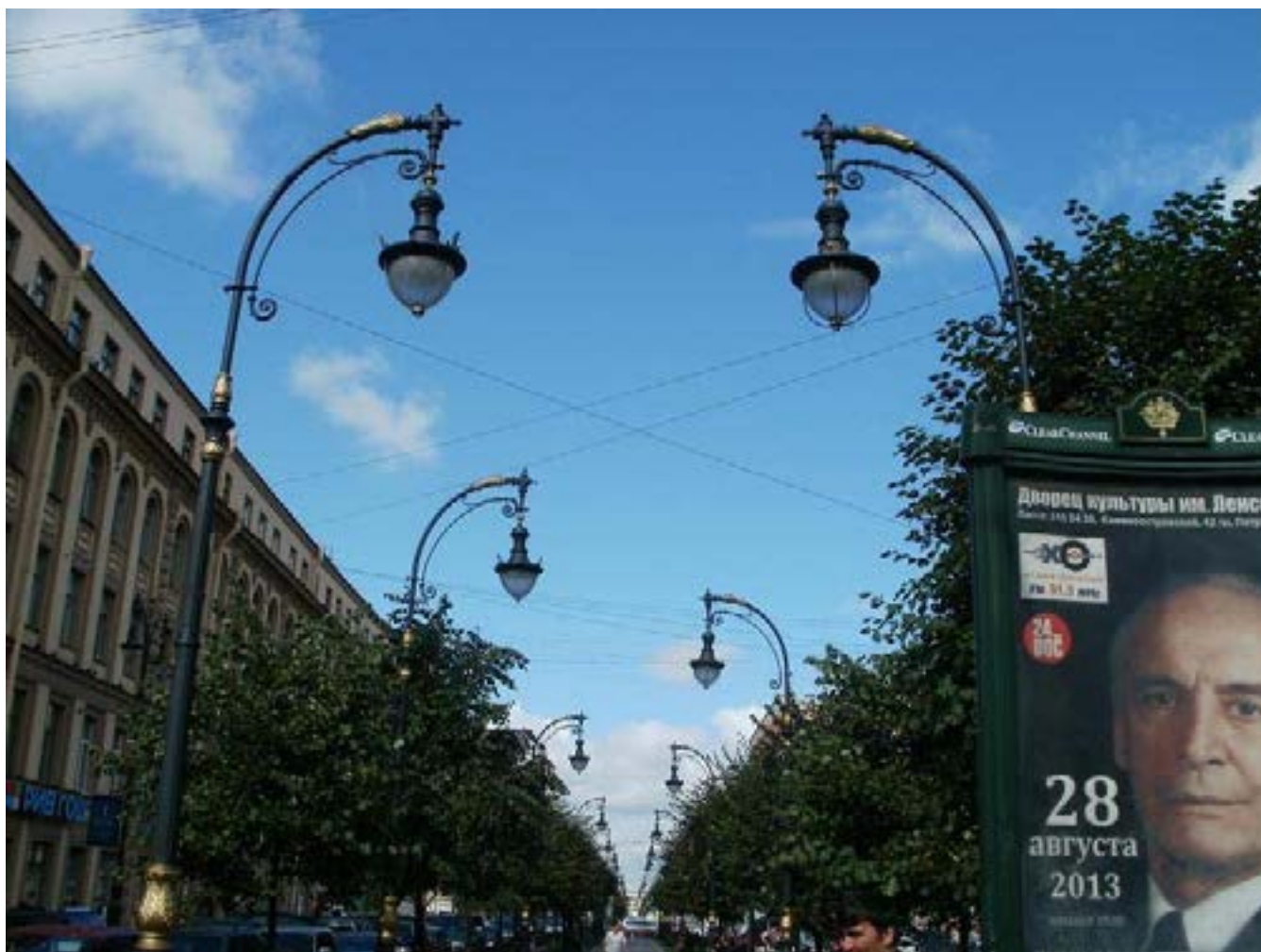
Рис. 160. Освещение пешеходной дорожки. Линия со светильниками V.13 (V.53) ДСУ13-хх-021. Проспект Чернышевского. 21 августа 2013 года.
