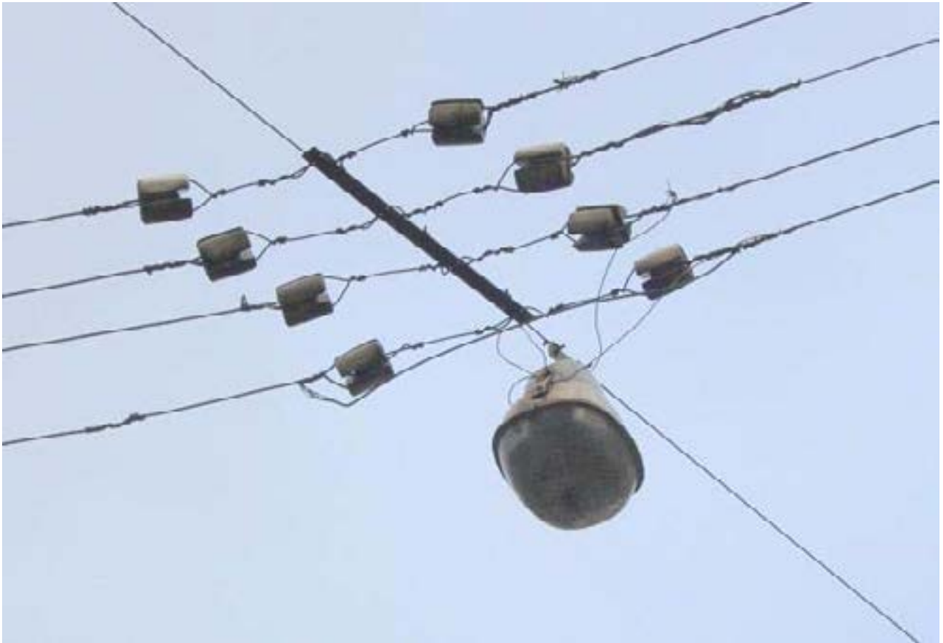
Рис. 89. Подвесная конструкция на такелажных изоляторах ИТ-70. Ивановская Улица. 31 октября 2014 года.
