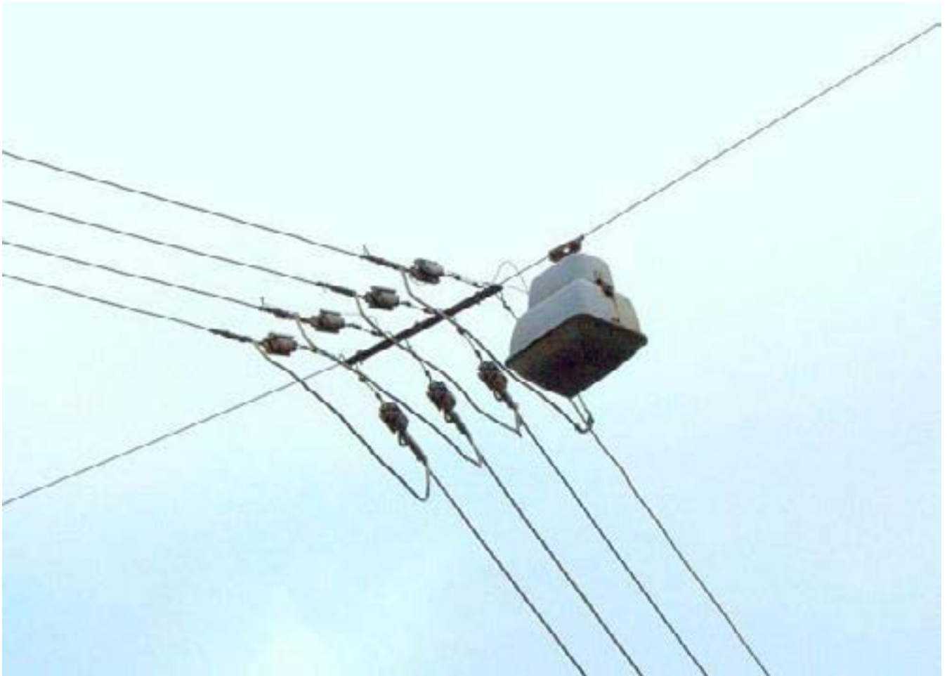
Рис 50. Аккуратный стиль крепления такелажных цилиндрических изоляторов на стальной проволоке, стандарта 1960-х – 1990-х годов.
