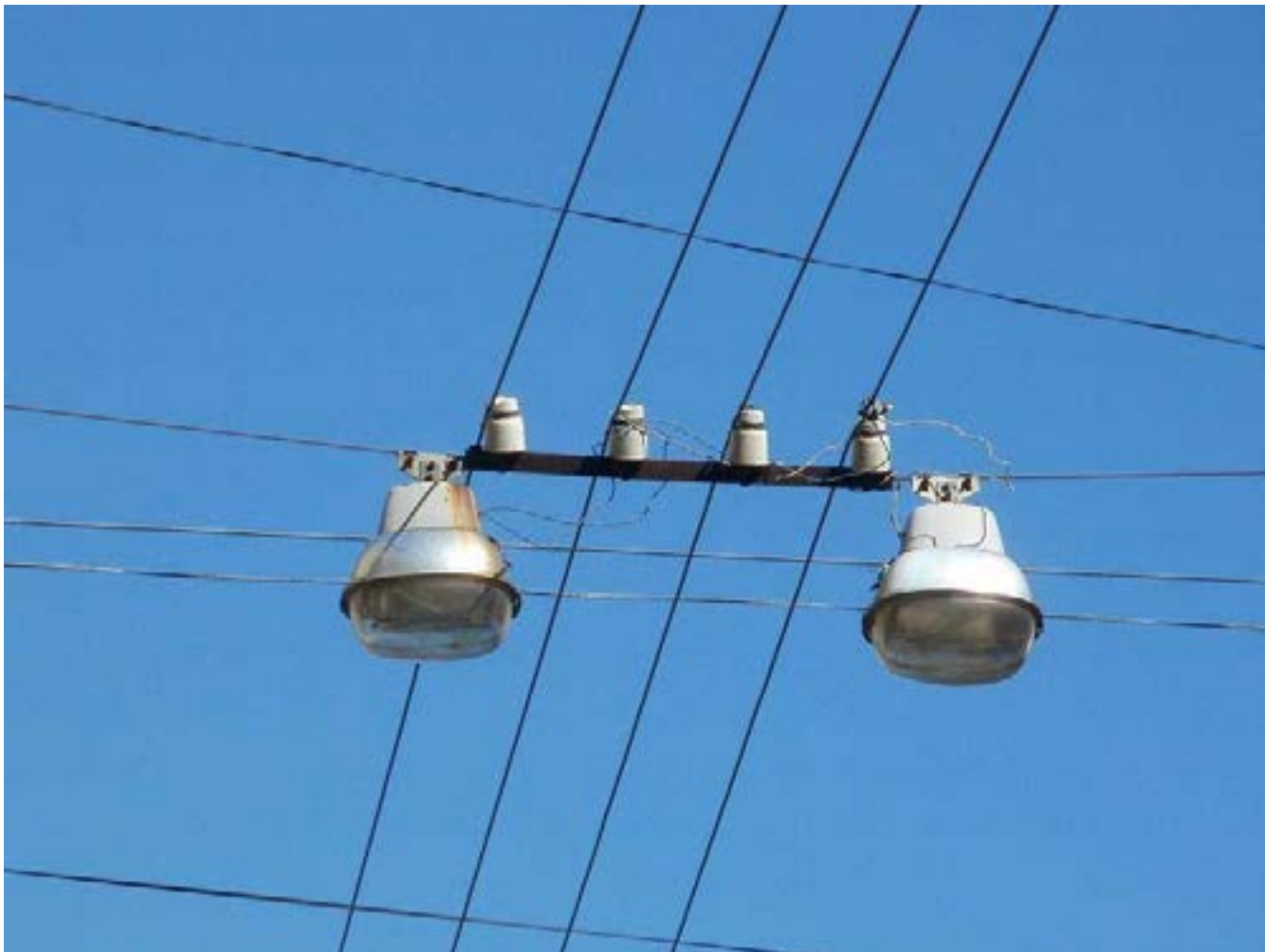
Рис. 131. Растяжка с двумя ЖСУ18 по разные стороны от проводов. Верейская улица. 23 августа 2013 года.
