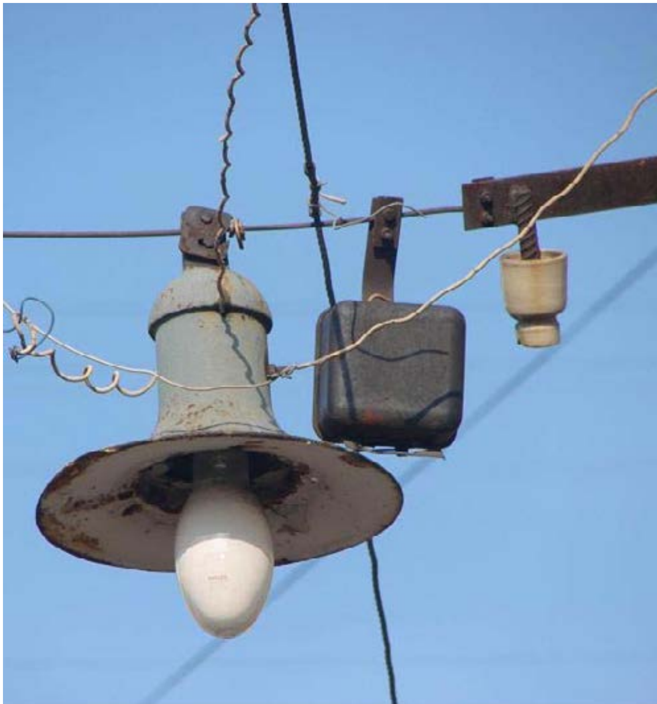
Рис. 68. Остатки линии с СПУ-300 и ртутной лампой высокого давления 250 Вт. Апраксин Двор. 11 августа 2014 года.
