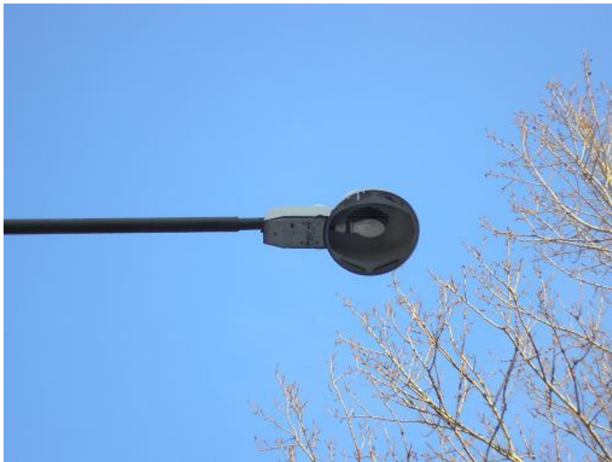
Рис. 2. Светильник РКУ07-125-002 (версия 1). Вид с земли. Подъездной путь вдоль дома (ул. Белы Куна 25 корп. 6).
